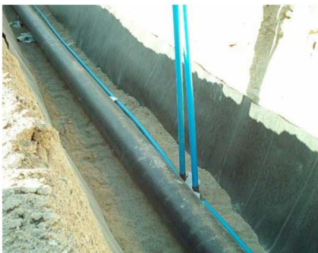
Щелевой кабельный канал из ПВХ Schedule 80, проложенный вдоль линии подачи топлива под самолетной стоянкой
